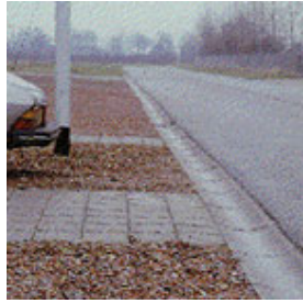
Molsgoot in betonuitvoering
